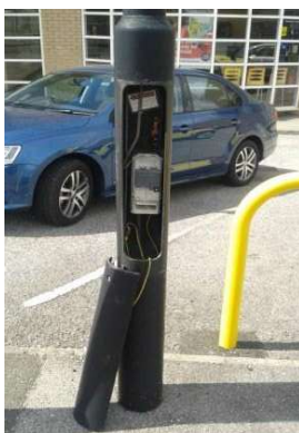
Lamp column door off
